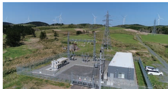
送電起点の1つである当社開源開閉所と連系する風力発電所
