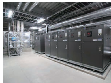
水冷ヒートポンプチラー
