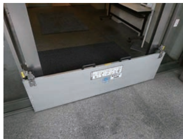
事務所等の水害対策の一例(止水板)
