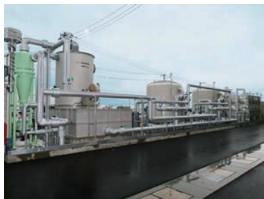
井水処理設備
